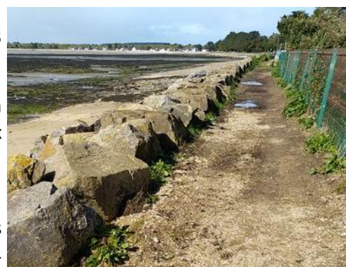
Érosion de la crête de T2 suite à une marée de 112 (09/04/24)
